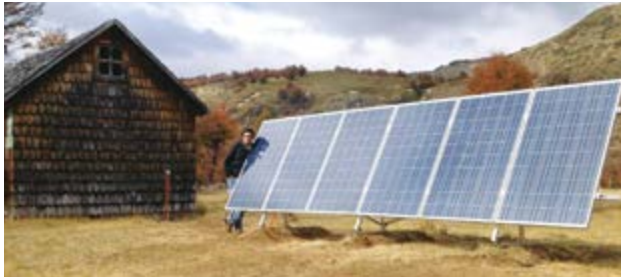
Paneles fotovoltaicos para localidad de Lago Verde, XI Región.
